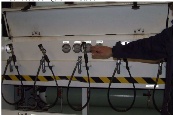
Anschlüsse der Quick-Fill-Station
